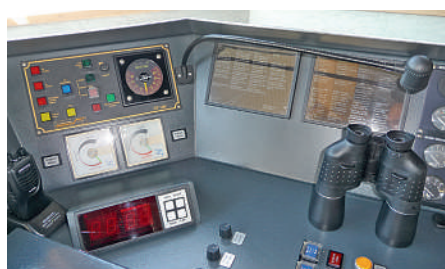
Ruder- und Warnanlage im Steuerhaus
